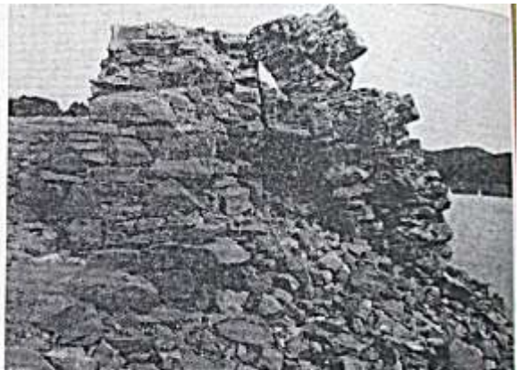
Auf eigene Gefahr besichtigt werden können wieder einmal die Reste der vermauerten Dämme Edersee. Doch die Gefahr wird von Jahr zu Jahr größer!
